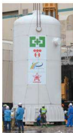
フィルタベント設備
